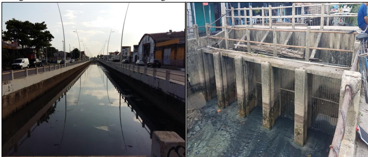
Fotografia 2 – Estruturas de macrodrenagem da microbacia da Tamandaré.
