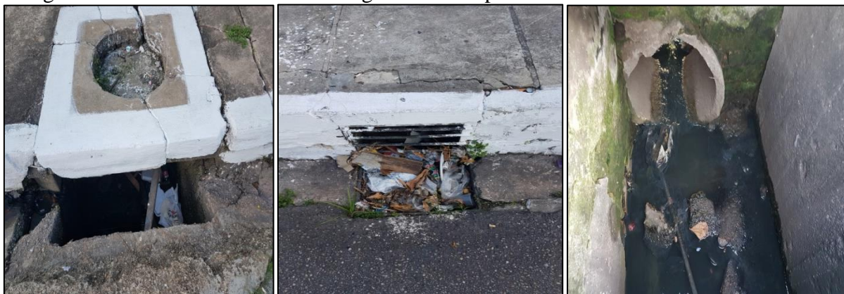
Fotografia 1 – Estruturas de microdrenagem de áreas próximas ao canal da Tamandaré.
